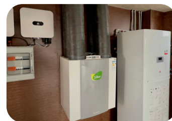
Sistema de ventilação da habitação
